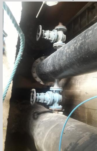
Chambre de vannes inférieure
