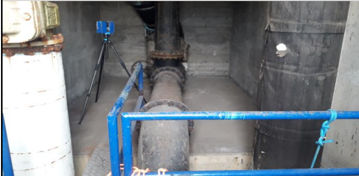
Chambre de vannes supérieure
